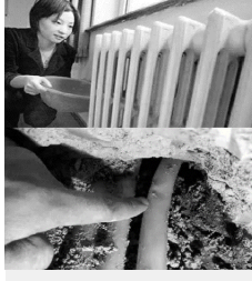
Isıtma Boruları / Yerden Isıtma Borusu Kaçakları
