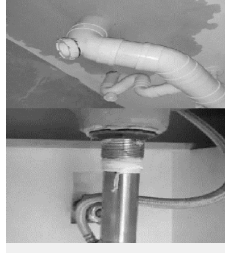
Su Tesisatı Boru Kaçağı / Su Borusu Kaçağı
