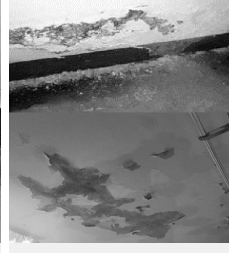
Çatılar ve Duvarlar, Zemindeki Su Sızıntısı
